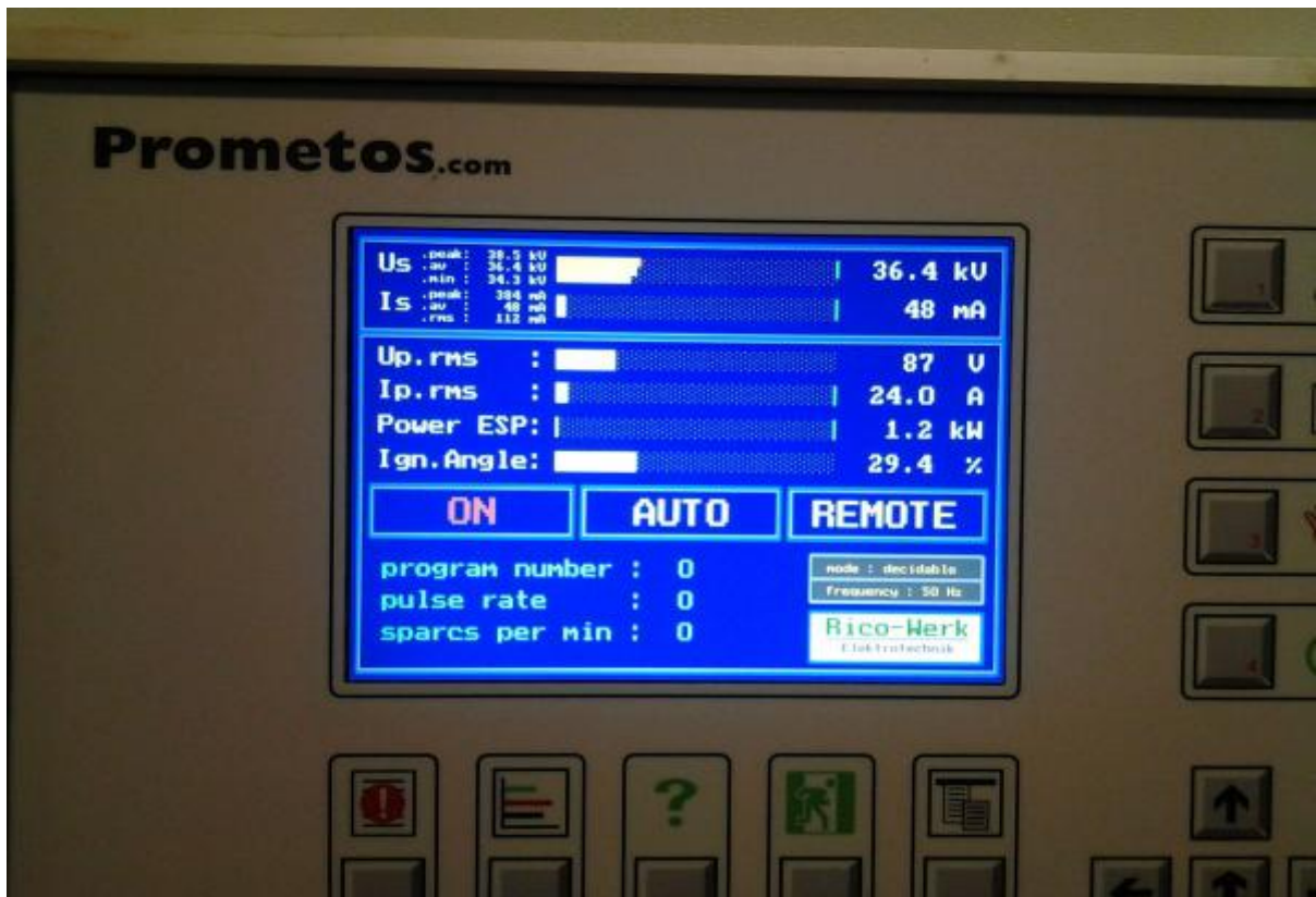
Trafo Regler: Daten während des Hochfahrens mit reduzierter Spannung nach Spülung
