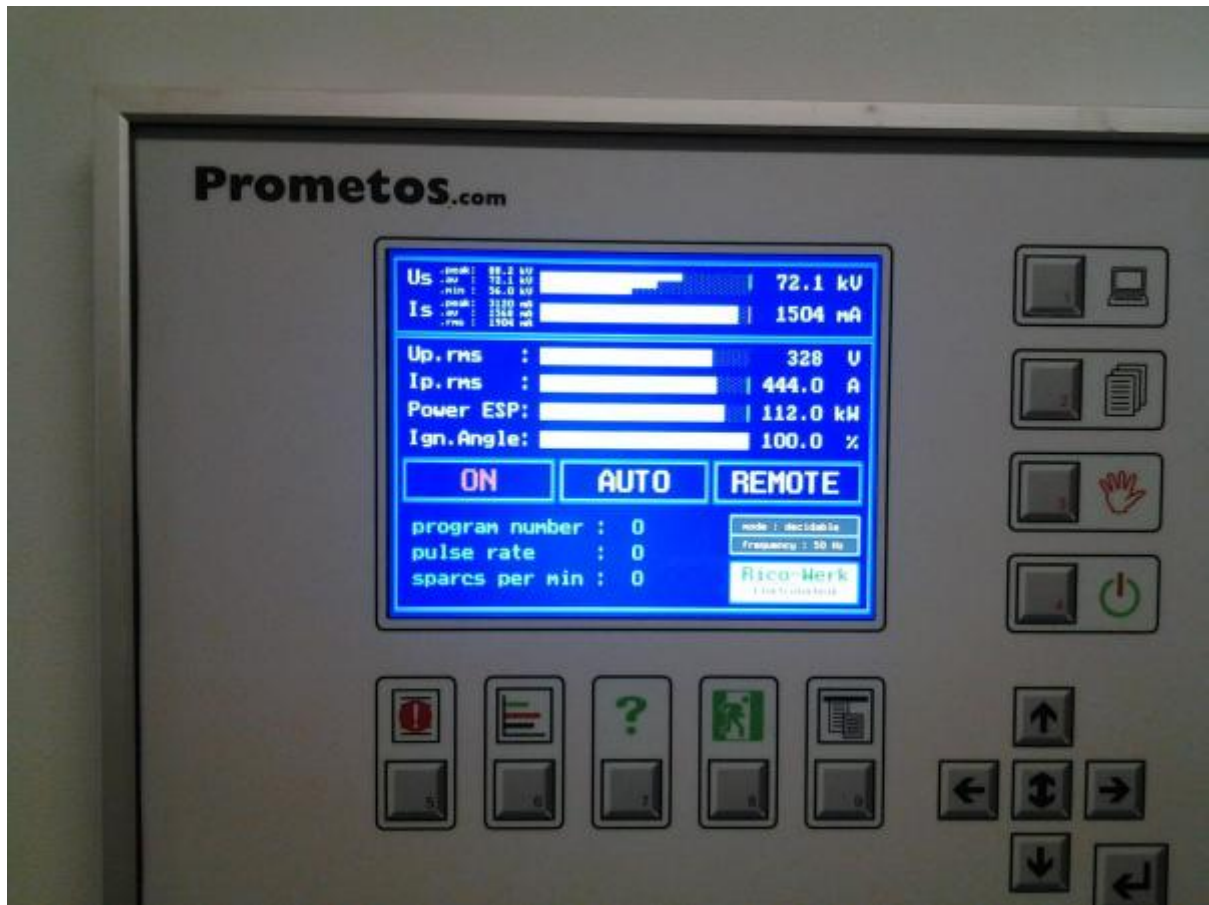
Trafo Regler: Daten im Vollbetrieb
